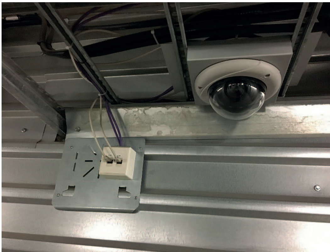
Kuva 20. Väärin tehty asennus: kameraverkkoon on suora pääsy esiin jätetyn verkkorasian kautta.
